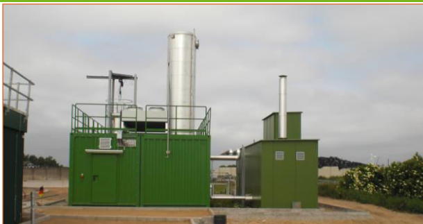
Blockheizkraftwerk (BHKW) Cogeneration unit
