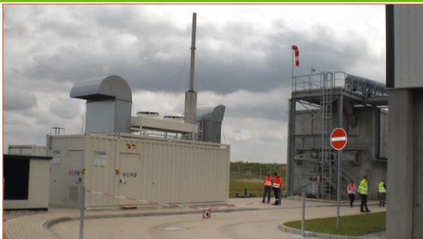
Blockheizkraftwerk Cogeneration unit
