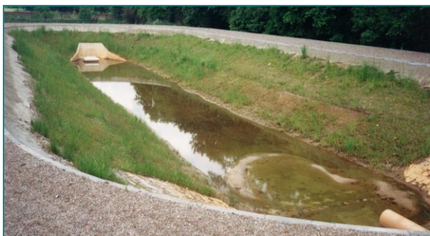
Absetzbecken Sedimentation basin
